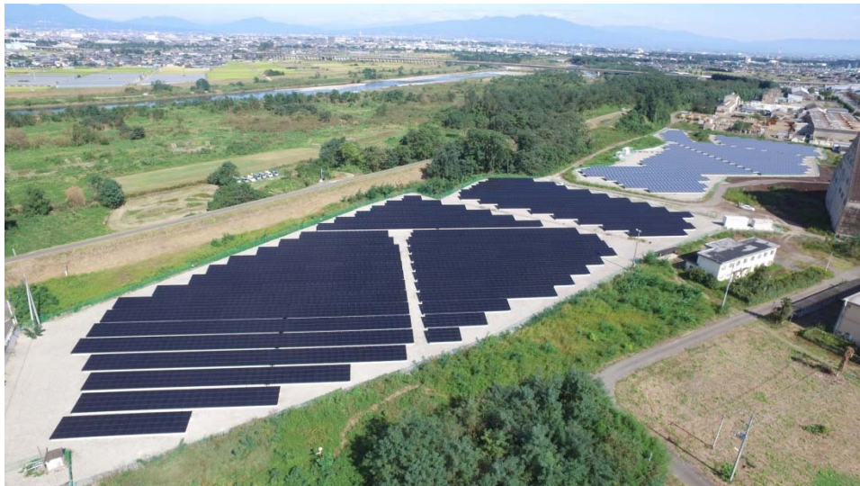
増設ソーラーパネル (手前)
