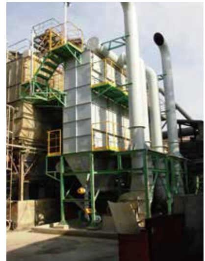
バグフィルター (契島製錬所)
