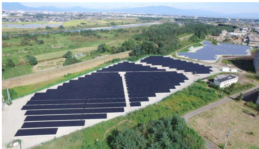
藤岡事業所太陽光発電所（群馬県） ・パネル設置面積：26,630m 2 ・発電出力 2014年運転開始：992kW 2016年増強工事：1,987kW（合計）
