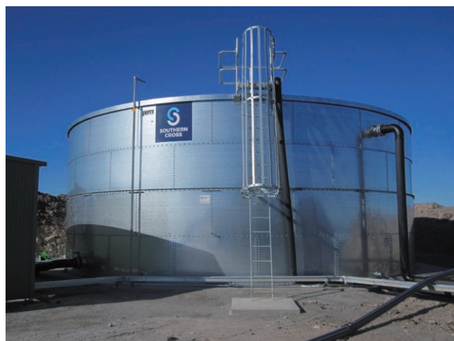
スプリンクラー用貯水タンク
