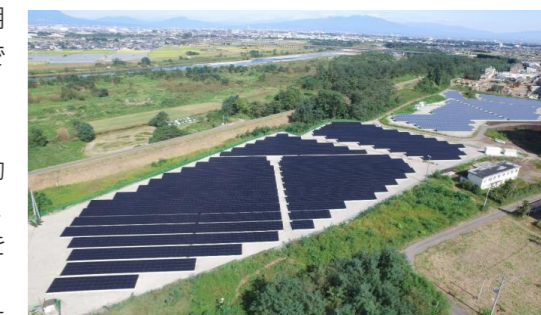
藤岡事業所太陽光発電所 (群馬県) ・パネル設置面積: 26,630m 2 ・発電出力 2014年運転開始: 992kW 2016年増強工事: 1,987kW (合計)
