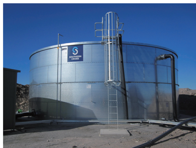
スプリンクラー用貯水タンク
