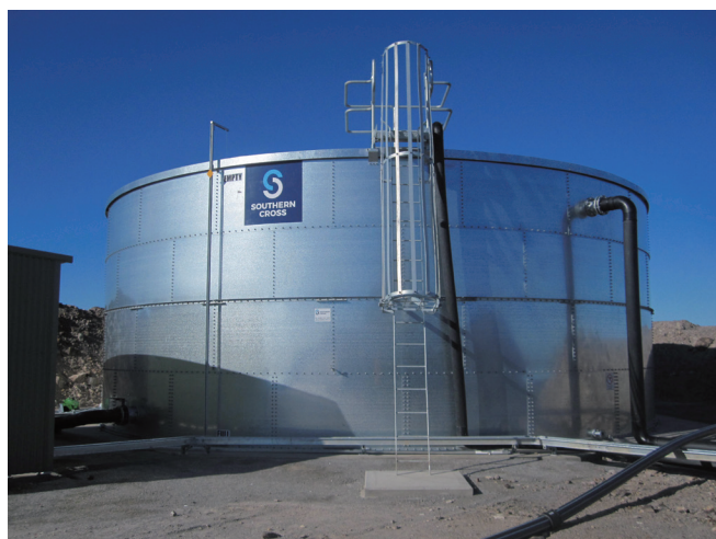
スプリンクラー用貯水タンク
